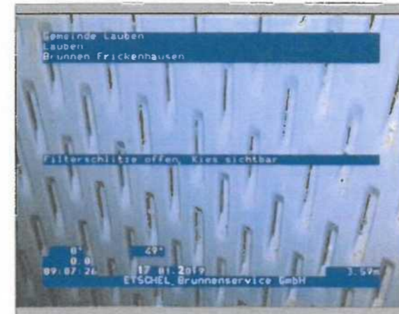
Foto: 1_1_7_17012019_090558_A.JPG 3.59m, Filterschlitz offen, Kies sichtbar
