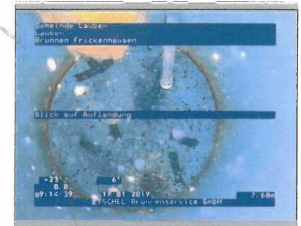
Foto: 1_1_11_17012019_091311_A.JPG 7,6m, Blick auf Auflandung
