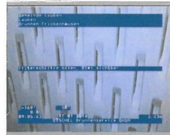
Foto: 1_1_5_17012019_090415_A.JPG 2.43m, Filterschlitz offen, Kies sichtbar
