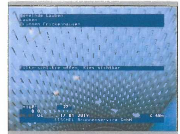
Foto: 1_1_8_17012019_090736_A.JPG 4.6m, Filterschlitz offen, Kies sichtbar
